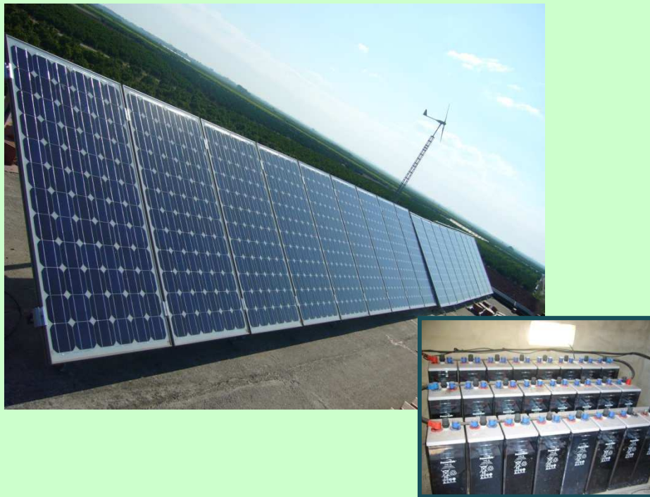
Instalación aislada en Sollana (Valencia)
